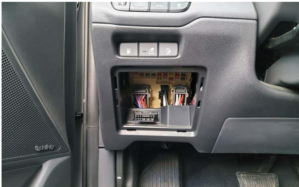
Bild 6 : Abdeckung Sicherungskasten fehlt
